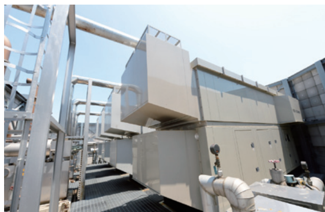
能代工場の自家発電設備
